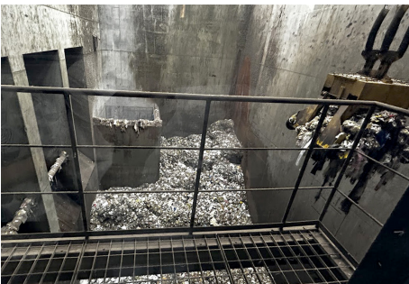
ピットではひと掴みが2tトラック1台分の巨大なクレーンがごみを掴みでは落としを繰り返し、攪拌してから焼却炉へつながらるホッパへ落とします
